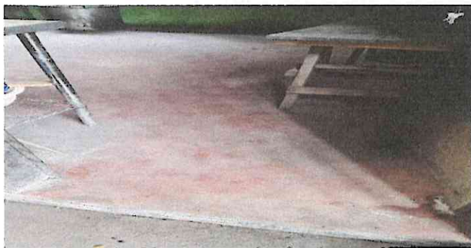
Foto 3: Piso de torta en mal estado.
