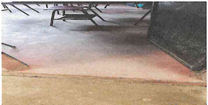
Foto 5: Piso de torta en mal deteriorado.
