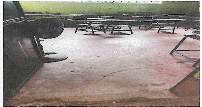
Foto 4: Piso de torta agrietada.
